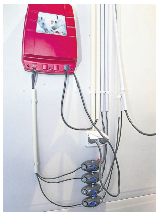
Jokaiselle tarhalle on oma sähkökatkaisimensa.
